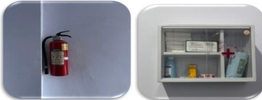
Gambar 16. Tabung Pemadam Kebakaran dan Tempat Obat-obatan
